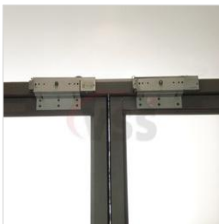
กลอนแม่เหล็กไฟฟ้าติดตั้งที่ประตู
